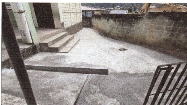
Entortado de cemento hacia los baños de niñas
